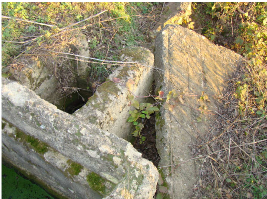
Изходна шахта на ОИ и енергогасител след нея
